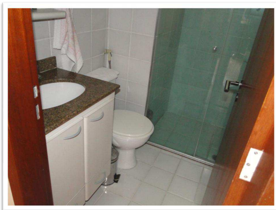
Foto nº 40 - Vista parcial do banheiro 1, como denominado na planta baixa no ANEXO 2 que serve aos dormitórios 1 e 2.
