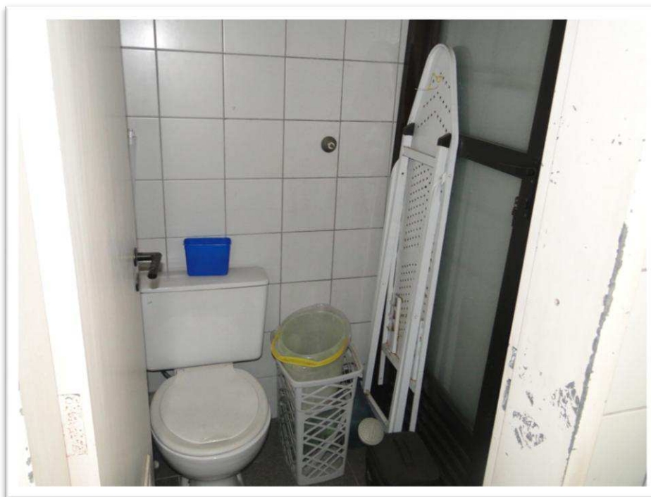
Foto nº 47 - Vista do WC junto a área de serviço do apartamento avaliando sob o nº 53, 5º andar do "EDIFÍCIO FLAMINGO PARK".
