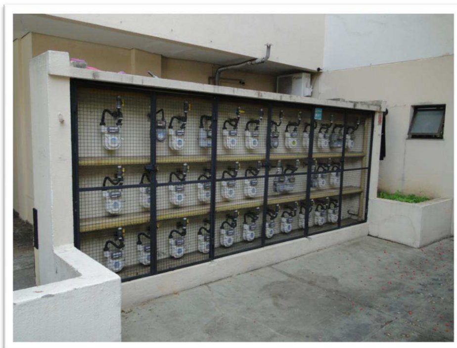
Foto nº 21 - Vista dos medidores de gás no pavimento térreo do prédio.
