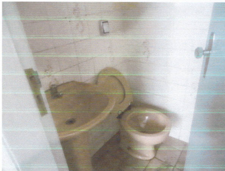
FOTO 6 – Pavimento térreo – banheiro.
